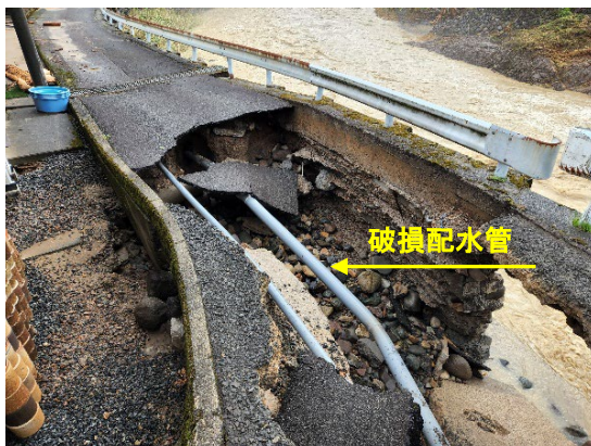
道路の崩落により破損(漏水)した配水管 (河原町中井)
