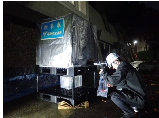
組立式の給水タンクを使用した給水 (応急給水所：佐治町総合支所)
